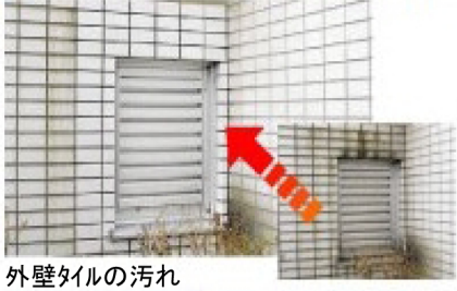
外壁タイルの汚れ
